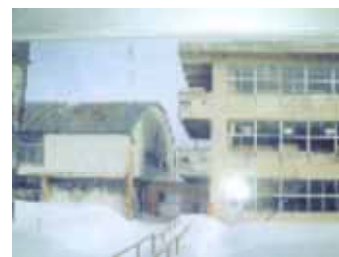
新城小学校の体育館と校舎、非常口のコンクリートが剥れ落ちていく。
